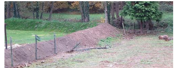
Verwallung / Mauern BCE, www.hochwassermanagement.rlp-umwelt.de
